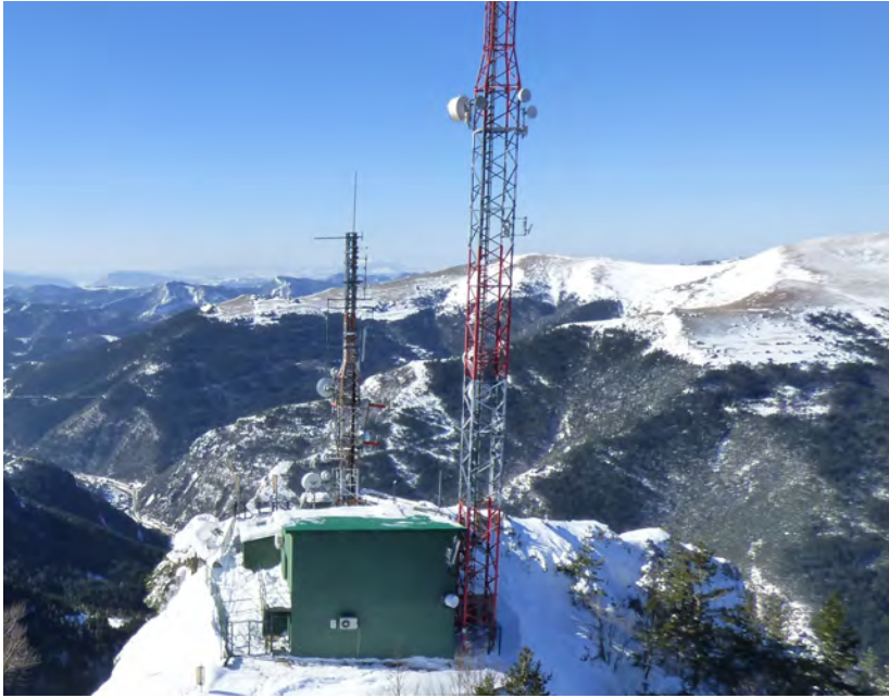
Centro de Telecomunicaciones de Isaba.
